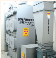
排気フィルターユニット (地下2階)
