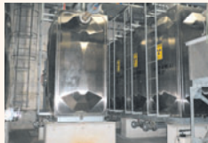
分配槽・尿貯留槽 (地下3階)
